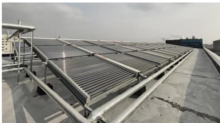
图：太阳能热水现场照片
